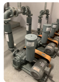
污水處理設備
